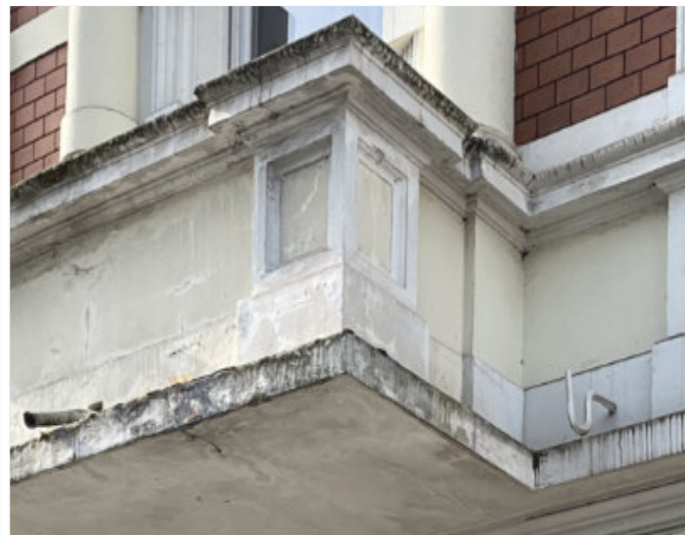
Feuchtigkeit- und Putzschäden
